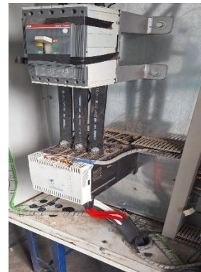
Arrancador suave de marca Siemens tarjeta de control dañada.
