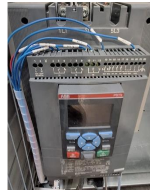
Arrancador suave de marca ABB nuevo.
