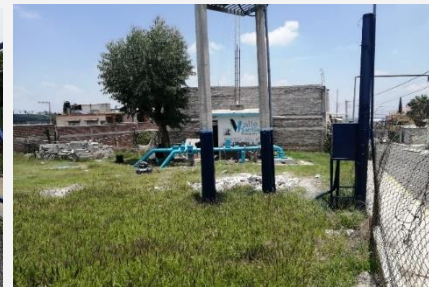
Pozo#7 Francisco Villa
